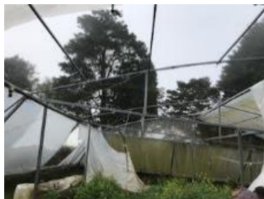
Afectación en ambiente protegido
