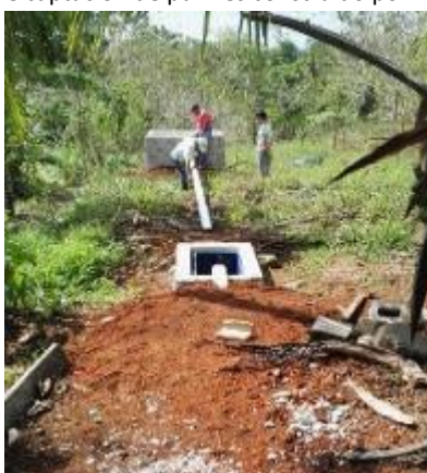
Desagüe y tanque de captación de purines construido por Mario Enrique Araya.
