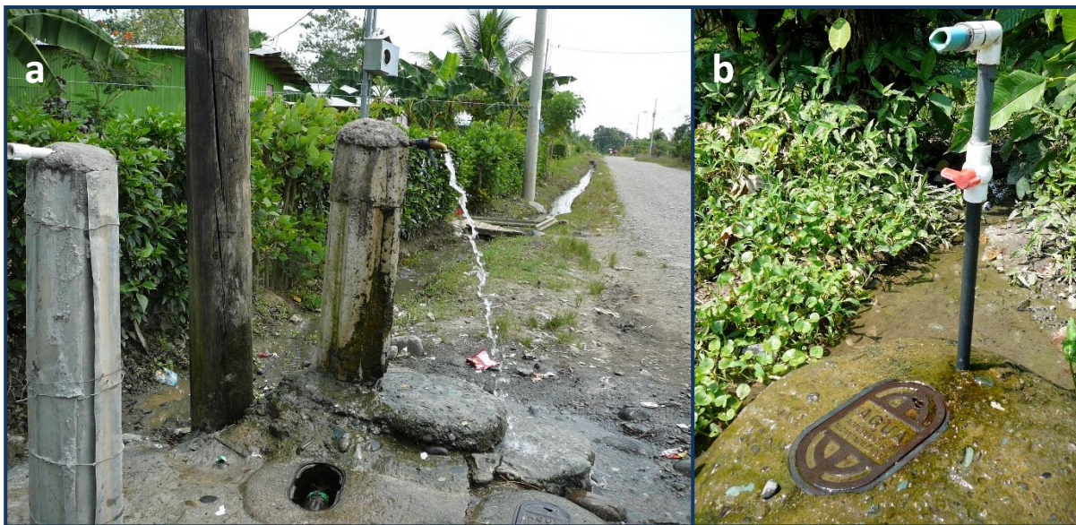
Figura 5. Tubo de agua de AyA, a) Comunidad El Jardín, Bataan; b) Comunidad Davao, Bataan.
