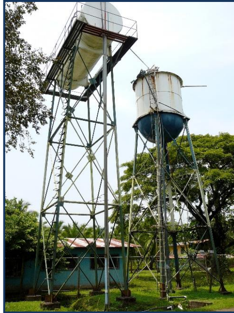
Figura 13. Tanque de Agua, ASADA B-line.
